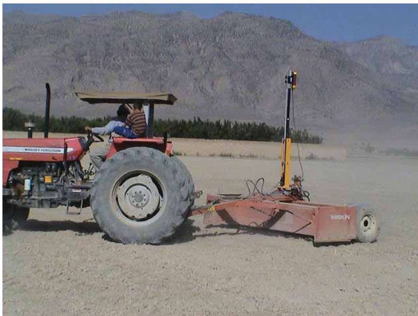
نگاره ۷- واحد تسطیح لولر لیزری مسکین ساخت کشور آمریکا در حین اجرای عملیات تسطیح در منطقه سروستان.
