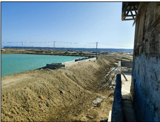
رسوبگیر و فیلترهای تعبیه شده در ابتدای ورود آب دریا به ابنیه رسوبگیر
