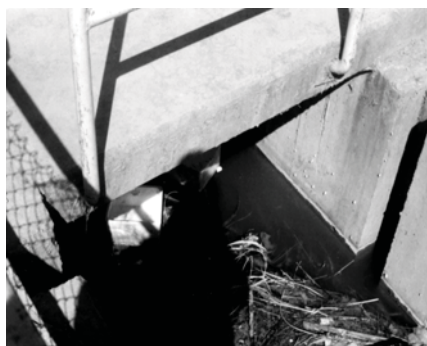
شکل ۷. گرفتگی دریچه‌ها به سبب نداشتن آشغال‌گیر مناسب
