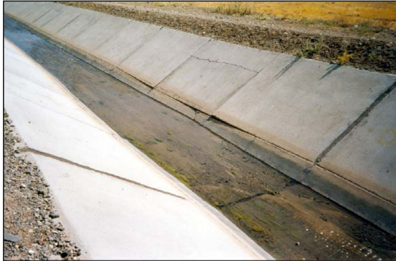
تصویر شماره (۱): بالازدگی پانلهای بتنی از محل درزهای اجرایی
