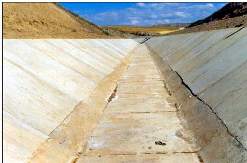
تصویر شماره (۲): بالا زدگی برخی پانلها از محل درزها قبل از اجرای سیستم فیلتر و زهکش
