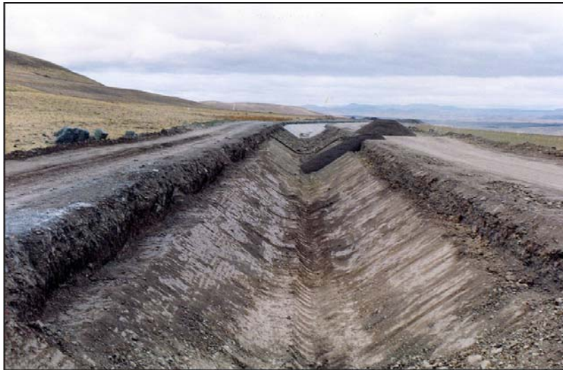
تصویر شماره (۴): ترمیمینگ و حفاری حوضچه محل استقرار لوله زهکش در زیر لاینینگ
