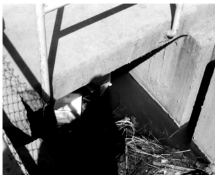
شکل ۷. گرفتگی دریچه‌ها به سبب نداشتن آشغال گیر مناسب
