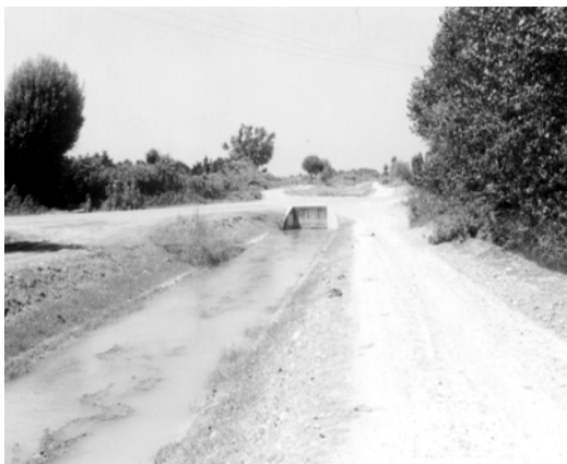
شکل ۱۴. پلی که با طراحی غلط عامل لبریزی کانال شده است (فاز ۱)
