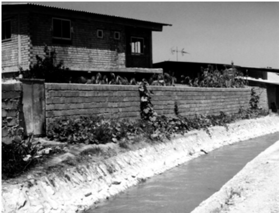
شکل ۱۳. احداث دیوار منازل و کشت در مجاورت دیواره کانال
