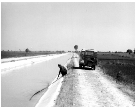
شکل ۶. مأمور بهره‌برداری در حال خارج ساختن سیفونی که به منظور بهره‌برداری غیر مجاز در کانال اصلی قرار داده شده است
