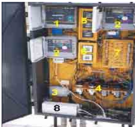
شکل ۴: تابلو کنترل به همراه اجزای آن
