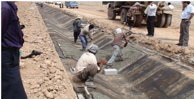
Fig. 8. a view of PBGM installation in Arayez Irrigation and drainage network (Une vue de l'installation PBGM dans Arayez irrigation et du réseau de drainage)
