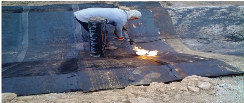
Fig. 7. A view of PBGM installation in Arayez Irrigation and drainage network (Une vue de l'installation PBGM dans Arayez irrigation et du réseau de drainage)
