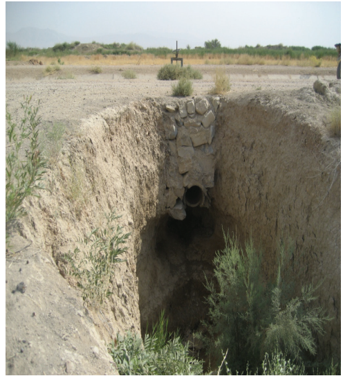
Fig. 3. Damaged turnout (Destruction de la fin de la turnout.)
